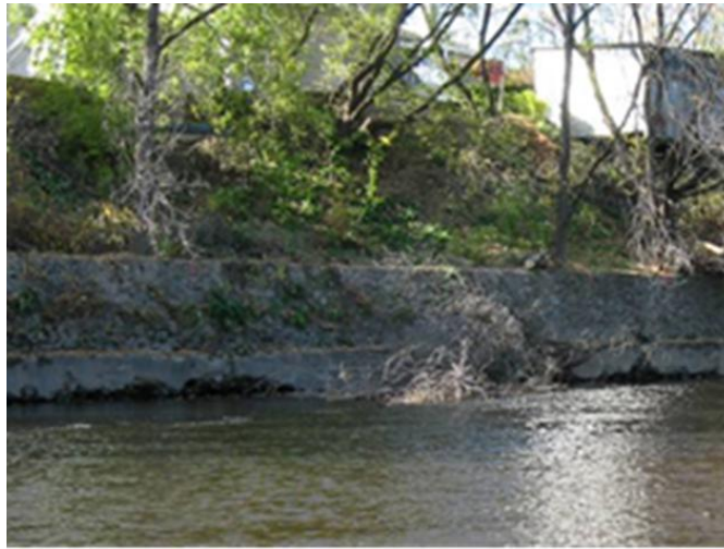
Photo 3. Muret de protection présentant des signes d'affouillement (érosion) à sa base (rivière du Gouffre, Baie-Saint-Paul)
